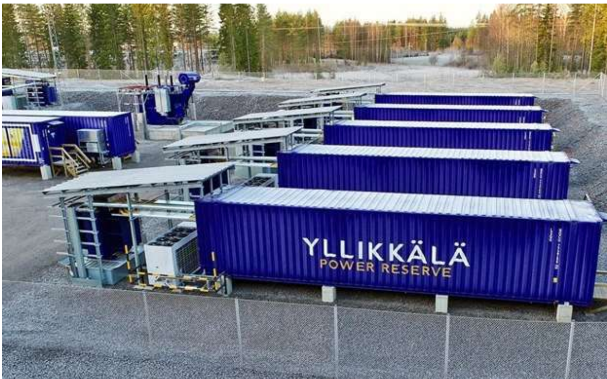
Bild 55. Exempel på batterilager, Neoens batterilager i Yllikkälä (Källa: https://www.kuljetuslehti.fi/2022/neoenin-akkuvarasto-toimittaa-nopeaa-varavoiimakapasiteettia-tvolle-olkiluoto-3-voimalaitosyksikon-kayttoonoton-aikana/ )
