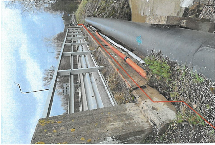
Mannerheiminkatu silta kaapelikiinnitys suojakourulla siltarakenteeseen. (Metallikouru siltakiinnityksillä)
