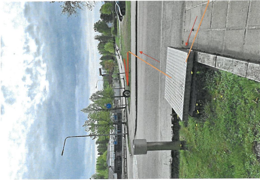
Linnunrata 6. Kaapelointi Loviisan keskuksesta.
