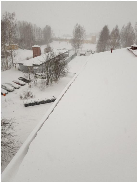
Kuva 35: Lumi-esteiden määrä oli puutteellinen.
