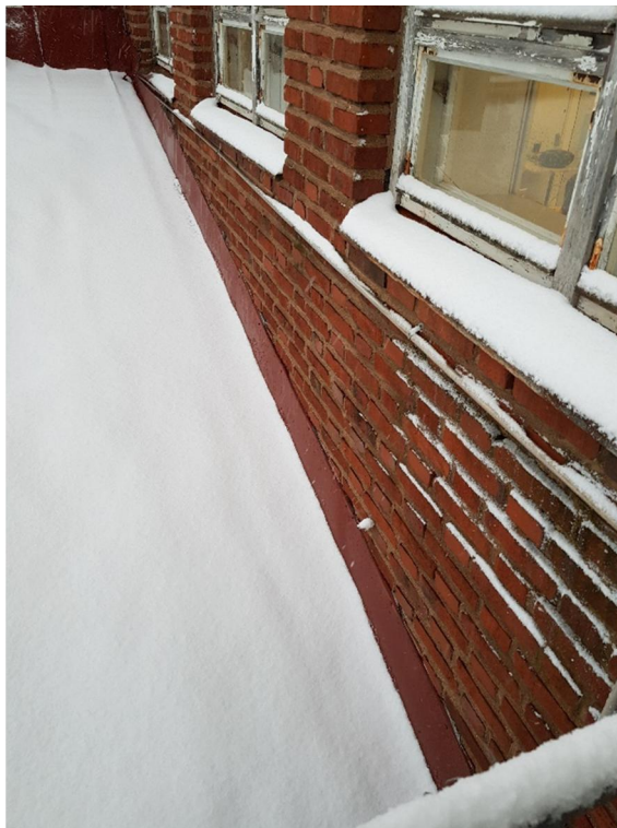
Kuva 36: Vesipellin saumaus julkisivuun oli puutteellinen.
