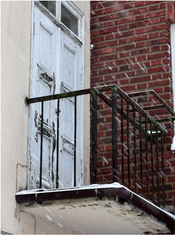
Kuva 27: Parvekkeen oven vaurioita.
