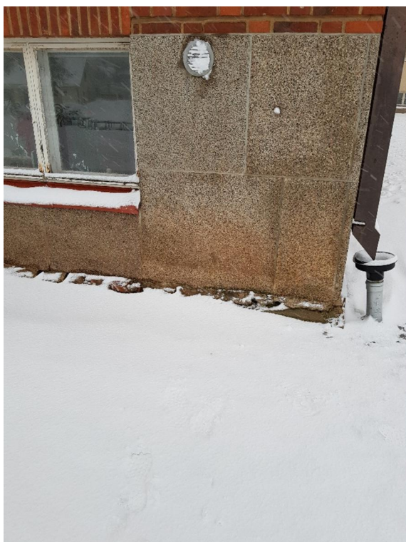
Kuva 4: Patolevyä tai listaa ei havaittu.
