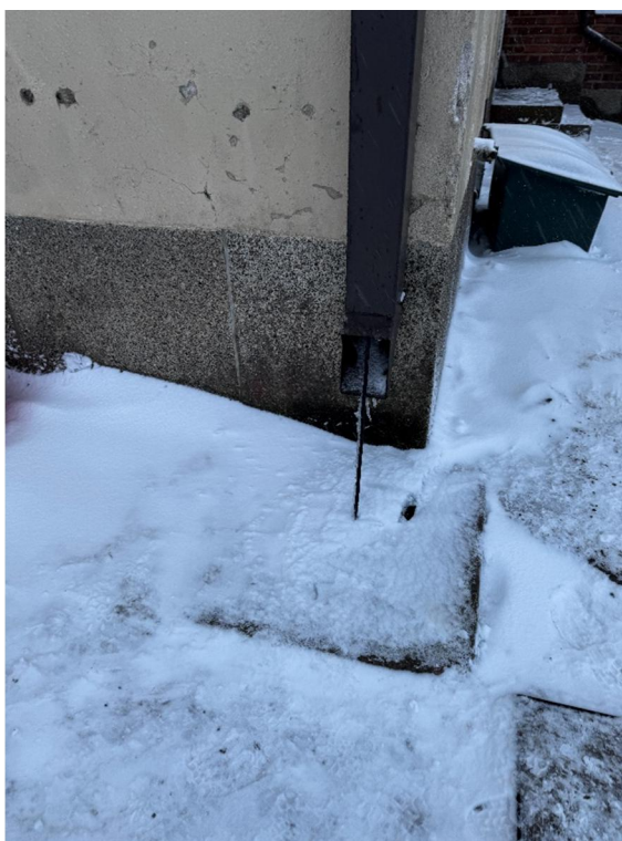
Kuva 5: Kattovedet oli johdettu sadevesikaivoon.
