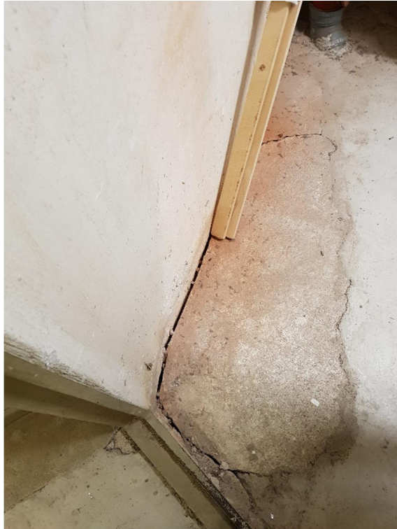
Kuva 9: Alapohjan liitoksissa ja lattioissa oli halkeamia.
