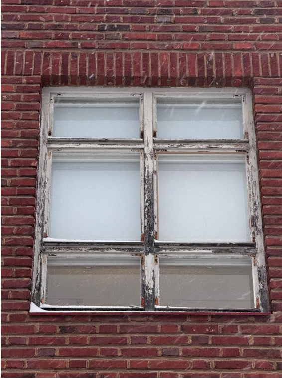
Kuva 29: Ikkunakarmit olivat välttävässä kunnossa.
