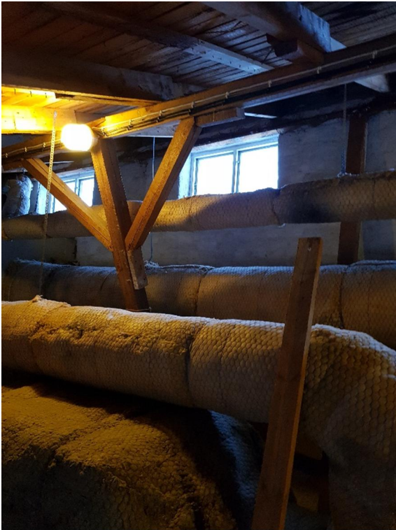
Kuvat 41: Putkien eristeissä on oletetusti asbestia
