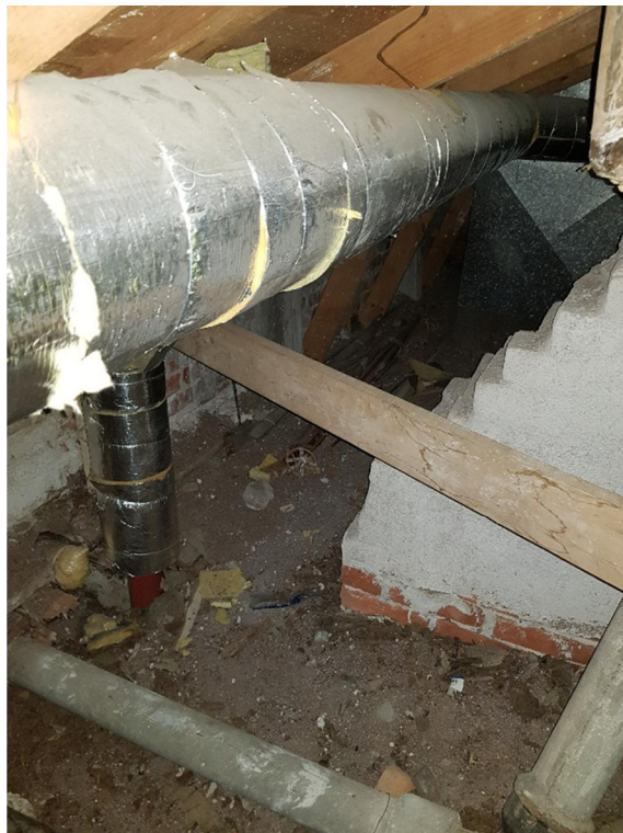
Kuva 40: Ullakkotilassa oli paljon pieneläinjätöksiä.
