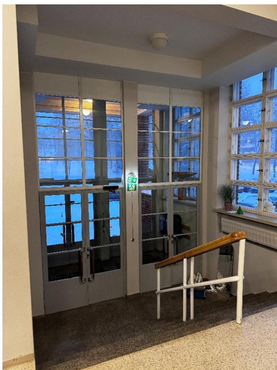
Kuva 25: Metallirungoissa oli pintakäsittely kulunut.
