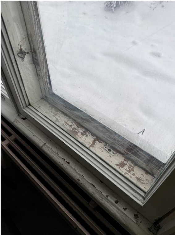
Kuva 19: Ikkunakarmien vaurioitunutta maalipintaa.
