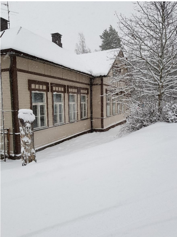
Kuva 3: Maanpinta kallistaa rakennukseen päin.
