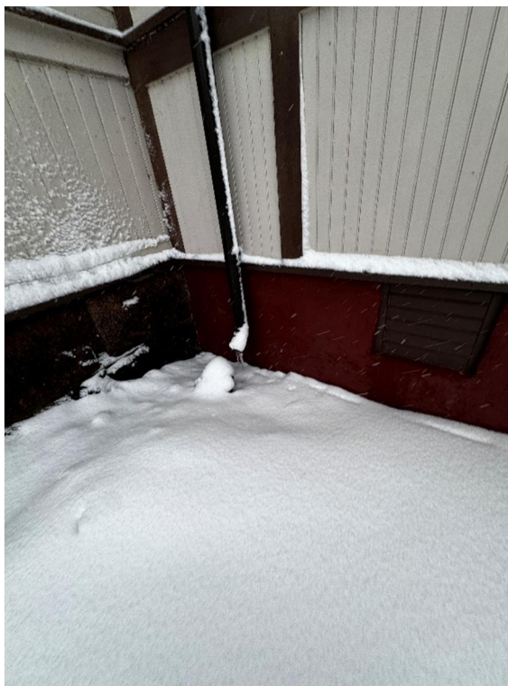
Kuva 7: Rännikaivo kokonaan irti syöksyputken alla.
