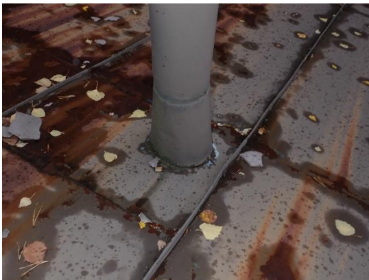
Kuva 29. Viemärin tuuletusputken liittymä vesikatteeseen ei ole tiivis
