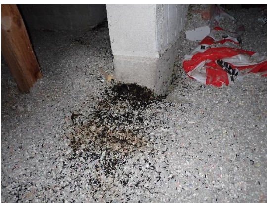
Kuva 35. Vesivuotojälki kulkusillan rikkoutuneen kiinnikkeen alapuolella
