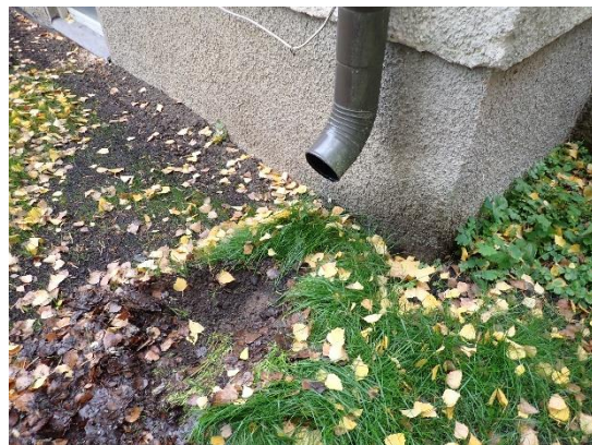
Kuva 44. Kattovedet suoraan rakennuksen vierustalle
