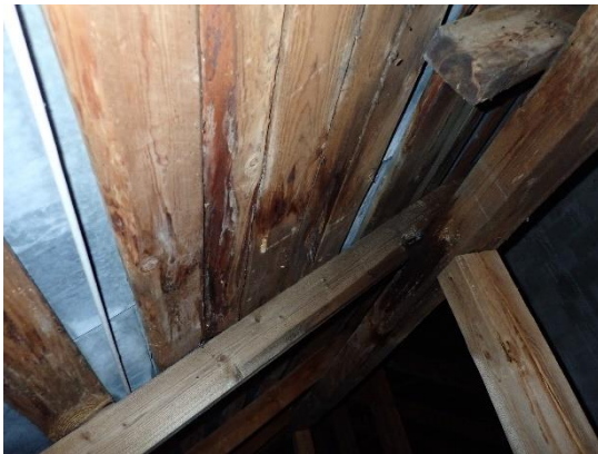
Kuva 37. Vuotojälki harjan läheisyydessä
