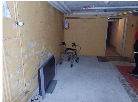
Kuva 10. Pinnoittamaton kellarin alapoha
