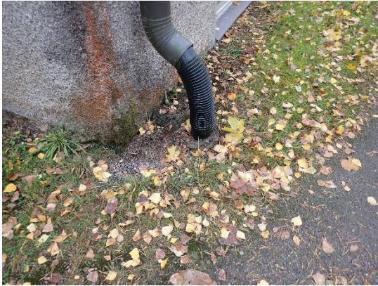
Kuva 45. Koulun tilojen puoleisella osalla sadevedet katolta betoniputkeen
