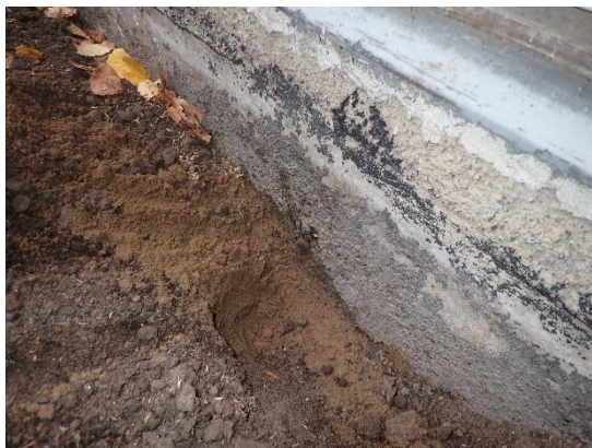
Kuva 1. Perusmuuri ulkopinta, vedeneristys puuttuu, sively irtoa helposti
