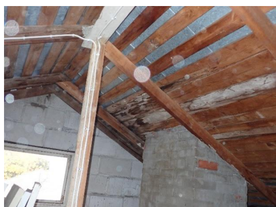
Kuva 34. Piipunjuurivuoto jälkiä YP tilassa
