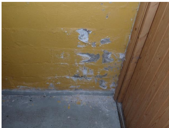
Kuva 3. Kosteusjälkiä kellarin väliseinäpinnalla
