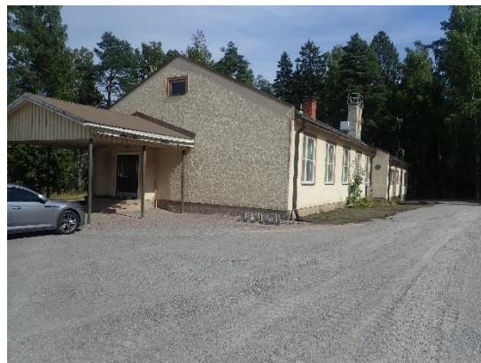
Kuva 42. Liikennealue ylärinteen puolella, pintavedet virtaavat rakennusta vasten.
