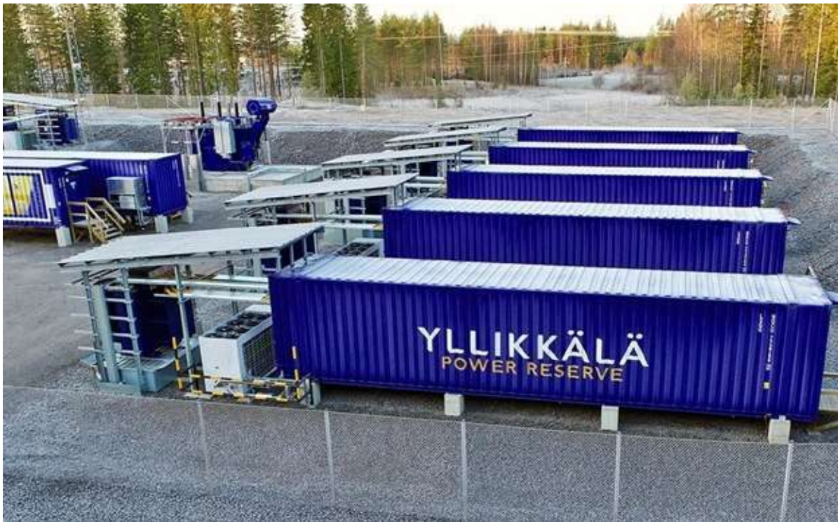
Kuva 55. Esimerkki akkuvarastosta, Neoenin Yllikkälän akkuvarasto (Lähde: https://www.kuljetuslehti.fi/2022/neoenin-akkuvarasto-toimittaa-nopeaa-varavoiimakapasiteettia-tvolle-olkiluoto-3-voimalaitosyksikon-kayttoonoton-aikana/ )
