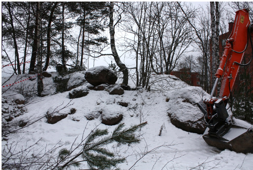
AKDG5145:17 Vallin koillispäähän on kasattu myöhemmin kiviä ja maata. Osa vallista jäänee maakasan alle. Etelästä. Kuva Katja Vuoristo.
