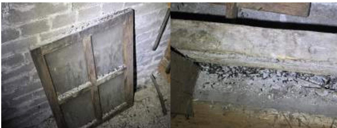
Kuva 4-1. Kuvia lepakoiden jätöksistä rakennuksen 1 ullakolta.
