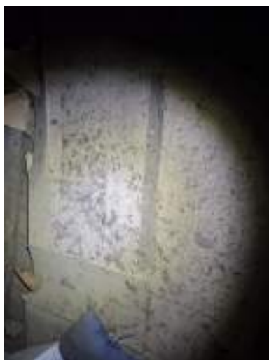
Kuva 4-2. Kuvia lepakoiden jätöksistä seinämässä rakennuksesta 2.
