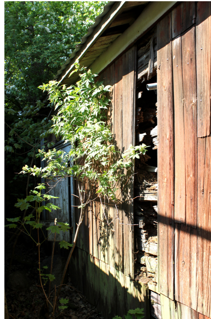
Bild 37. Träbyggnadens bakre fasad och taket har stora rötskador.
