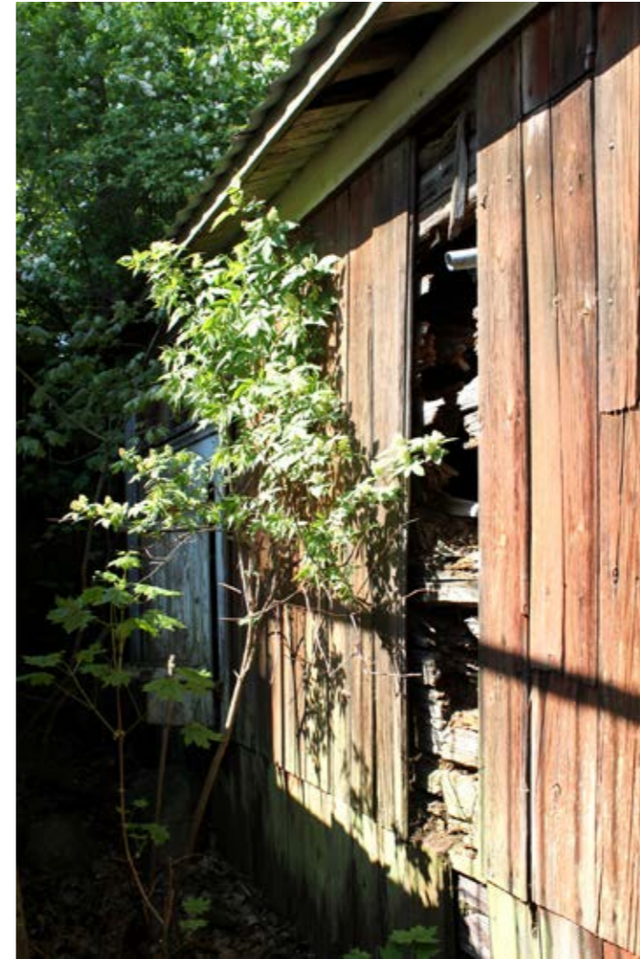
Kuva 37. Puisen rakennuksen takajulkisivu ja katto ovat pahoin lahonneet.
