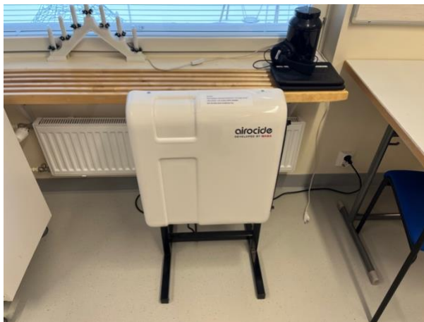
Luokkatiloissa oli Airocide-ilmanpuhdistimia.
