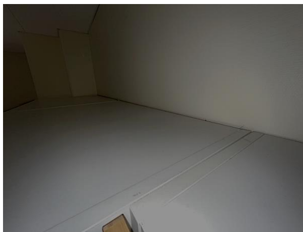
Kaapistojen päällä oli vähäistä pölykertymä
