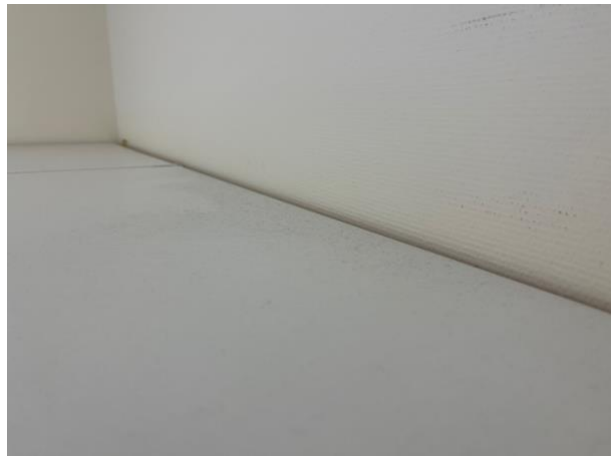
Kaapistojen päällä oli vähäistä pölykertymää
