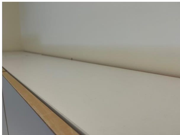
Kaapistojen päällä oli vähäistä pölykertymää
