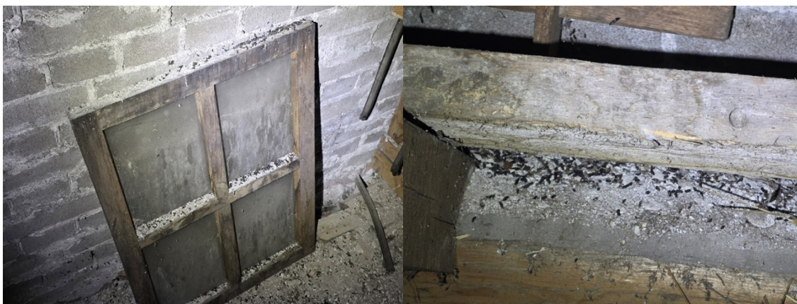
Kuva 4-1. Kuvia lepakoiden jätöksistä rakennuksen 1 ullakolta.
