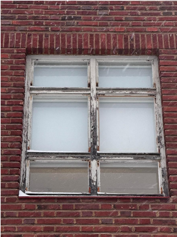
Kuva 29: Ikkunakarmit olivat välttävässä kunnossa.
