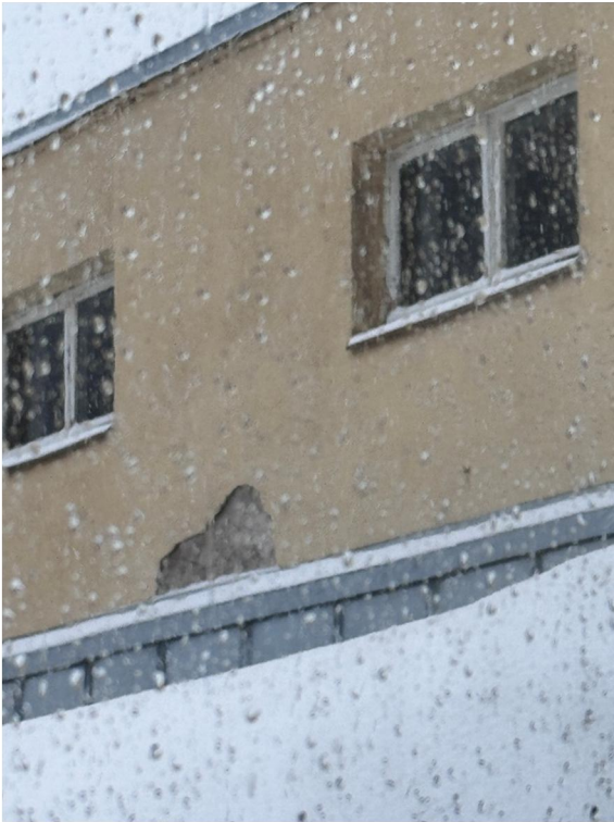
Kuva 20: Julkisivurappauksissa havaittiin puutteita.
