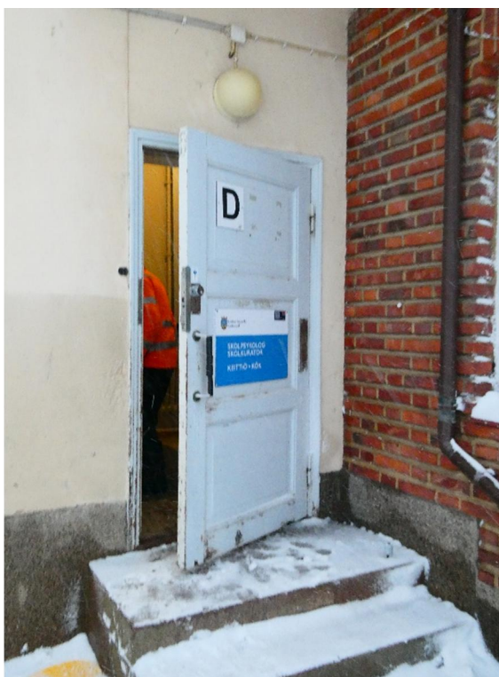
Kuva 26: Yleisten tilojen ulko-ovissa oli maalivaurioita.
