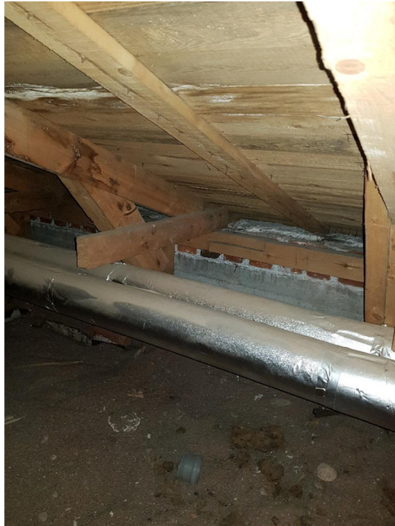
Kuva 38: Räystäällä ei ollut tuuletusta.
