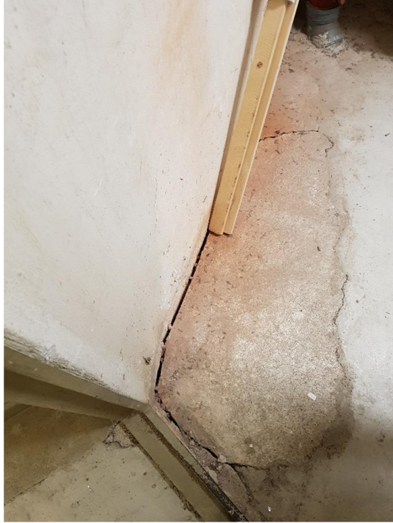
Kuva 9: Alapohjan liitoksissa ja lattioissa oli halkeamia.
