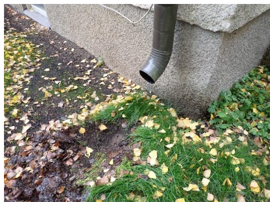
Kuva 44. Kattovedet suoraan rakennuksen vierustalle
