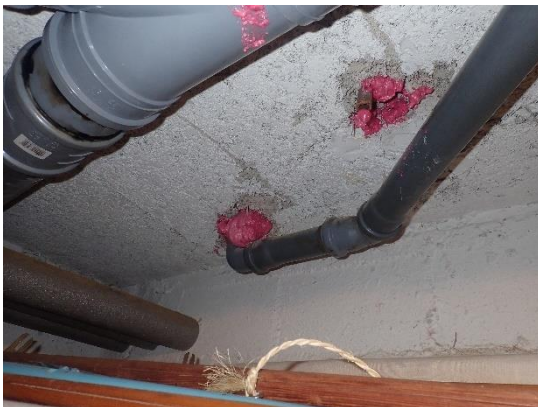
Kuva 25. Välipohjaläpivientejä kellari puolella, tiiveyspuutteita
