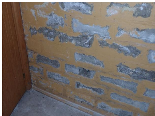
Kuva 4. Kosteusjälkiä perusmuurin verhomuusauksen pinnalla
