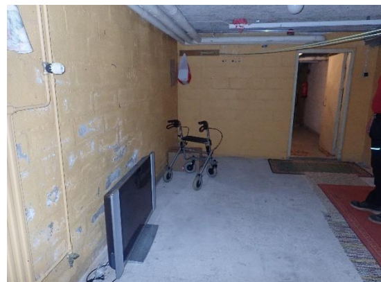
Kuva 10. Pinnoittamaton kellarin alapoha
