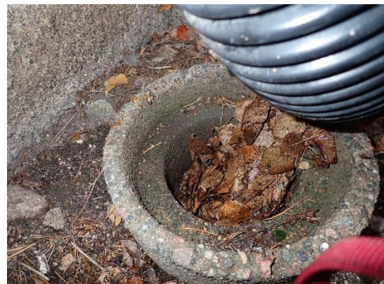
Kuva 46. Betoniputket ovat täynnä eloperäistä ainesta ja hiekkaa.
