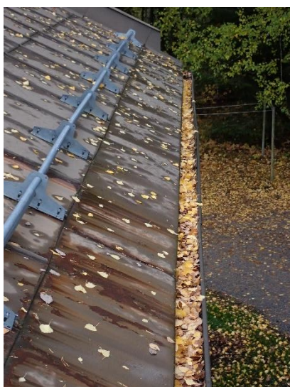
Kuva 43. Lapekouru vaatii puhdistusta
