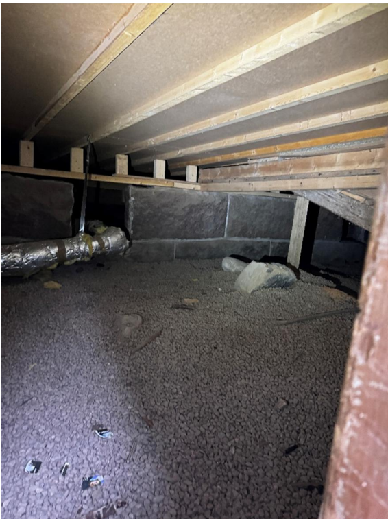
Kuva 10: Alapohjan palkkien tuenta oli painunut.
