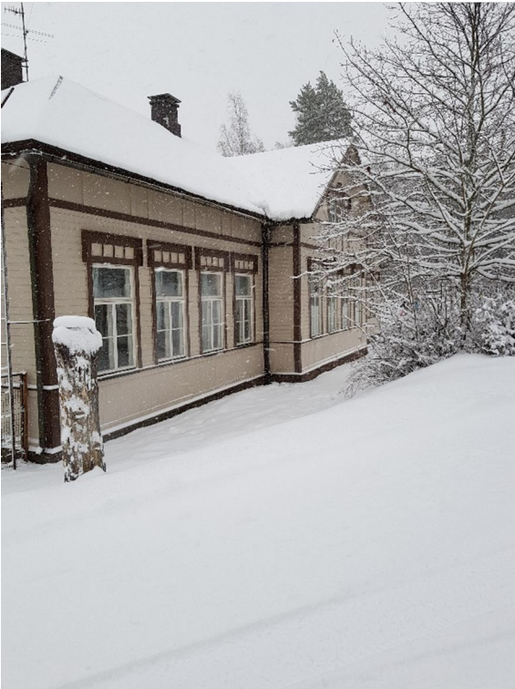
Kuva 3: Maanpinta kallistaa rakennukseen päin.
