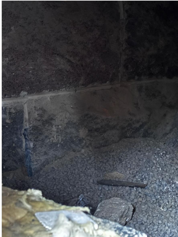
Kuva 9: Ryömintätilan maa-aines oli soraa.
