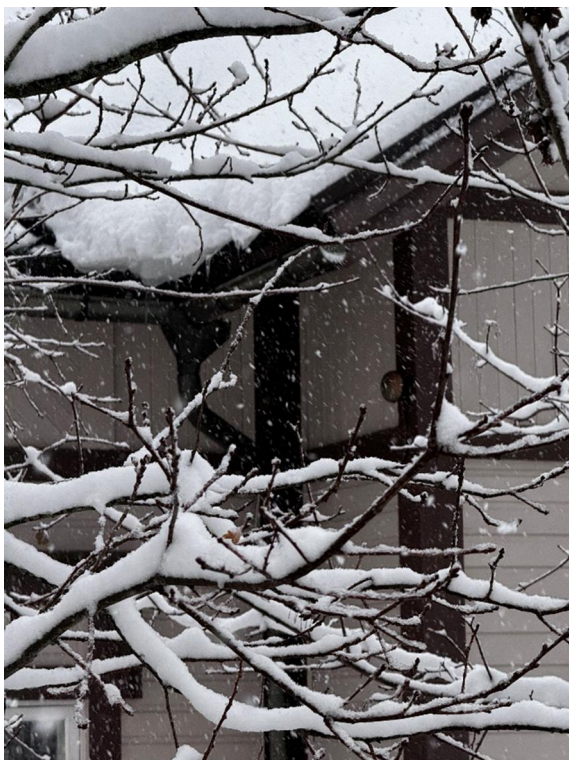
Kuva 6: Räystäskouruissa oli puutteita.
