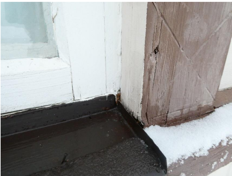
Kuva 20: Vesipellityksen saumaus puuttui.
